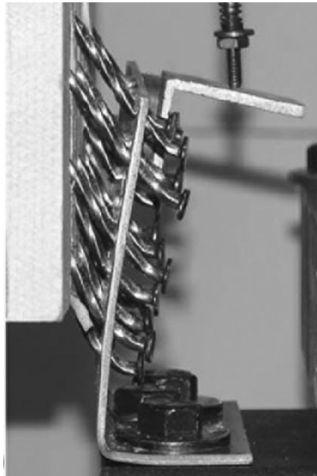
Abbildung 5.6 Versagensfall eines Zugankers bei Überschreiten der Tragfähigkeit der Nägel im Holzbauteil [19]
